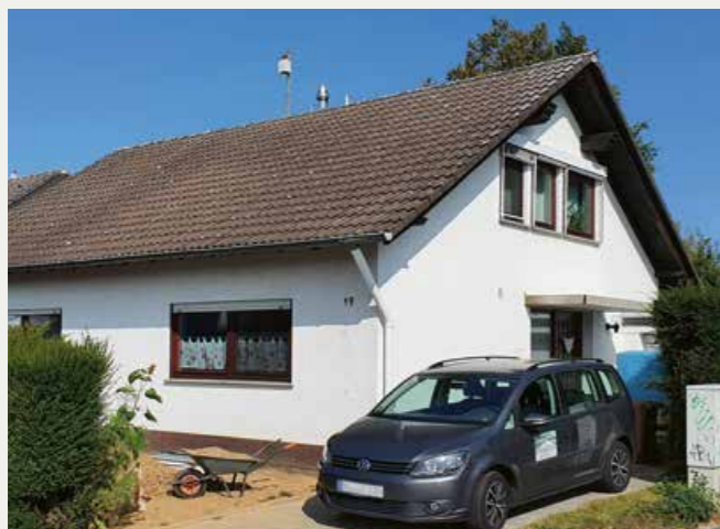
▲ Das Wohnhaus bei Köln vor der Modernisierung: Im Dachgeschoss herrschte ein kalter Luftzug und der Heizwärmebedarf war hoch
