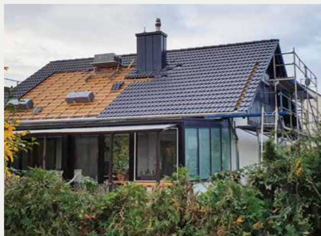
▲ Die Dacharbeiten wurden komplett von außen durchgeführt, sodass die Besitzer das Dachgeschoss währenddessen weiter nutzen konnten
