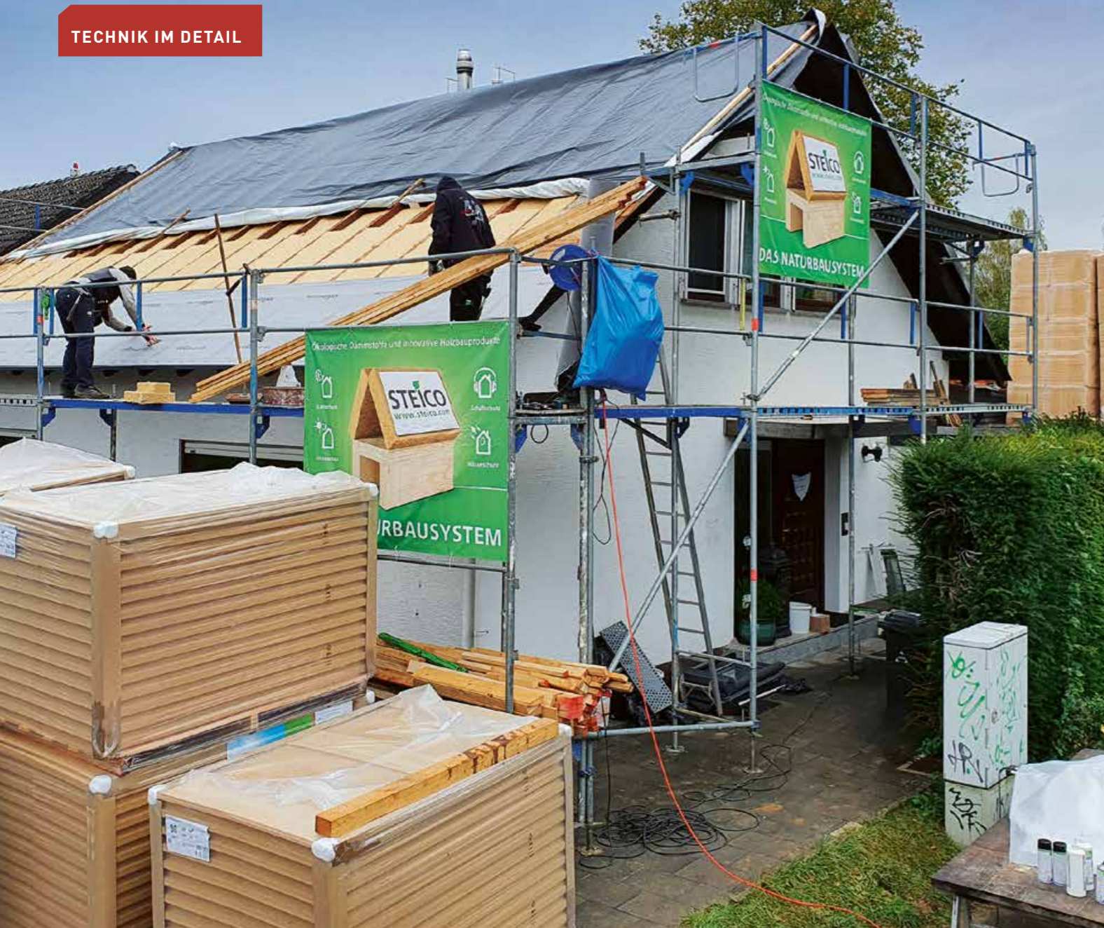
▲ Dachmodernisierung von außen: Bei diesem Wohnhaus aus den 1970er-Jahren (siehe Kasten auf Seite 42 unten) wurde auf eine Dampfbremse verzichtet
